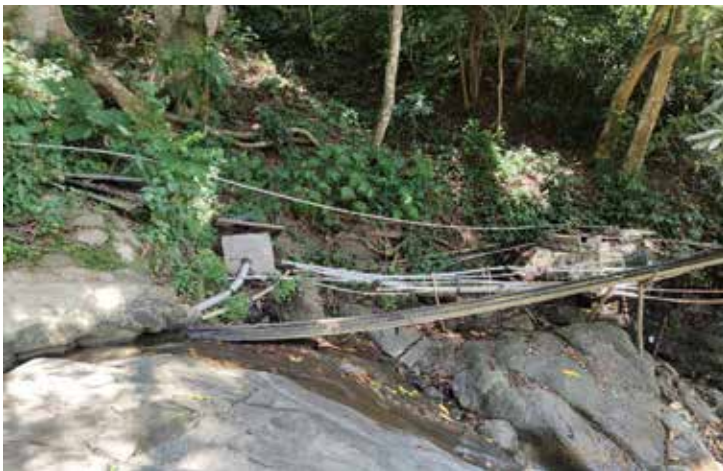
Gambar 11.7. Sumber mata air panas yang dialirkan dengan pipa-pipa menuju kolam-kolam yang dijadikan wisata pemandian air panas di Desa Cipanas
