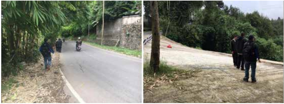
Gambar 1.26. Gerakan tanah tipe rayapan dan nendatan di jalur jalan di daerah Kab. Bandung Barat, (kiri) retakan yang muncul di jalan sebagai indikasi gerakan tanah tipe rayapan. (kanan) retakan yang sudah ditutup oleh semen.
