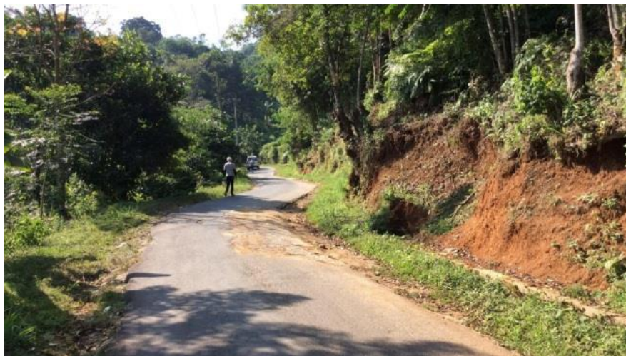
Gambar 4.60 Longsor pada tebing jalan yang mengakibatkan nendatan pada jalan di daerah Desa Cigudeg, Kec. Cigudeg, Kab. Bogor.
