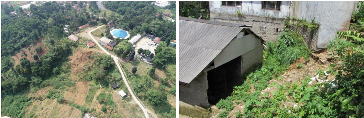
Gambar 4.56 Longsoran tanah pada lereng yang memiliki kemiringan terjal di Desa Ciherangpondok, Kec. Caringin (kiri); Tebing yang runtuh menimpa bagian belakang rumah di Kp. Kompa Satu, Desa Sipayung, Kec. Sukajaya (kanan).
